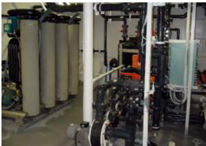
液状水製造装置
